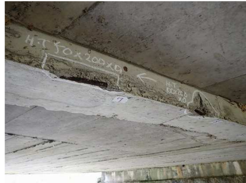
コンクリートの一部が剥離し 鉄筋が露出・錆が発生している
