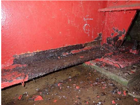
鋼材部の塗装が劣化し 錆が発生している
