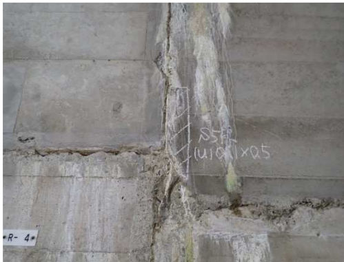
目地に沿った浮き・はく離 (Ⅱ)
