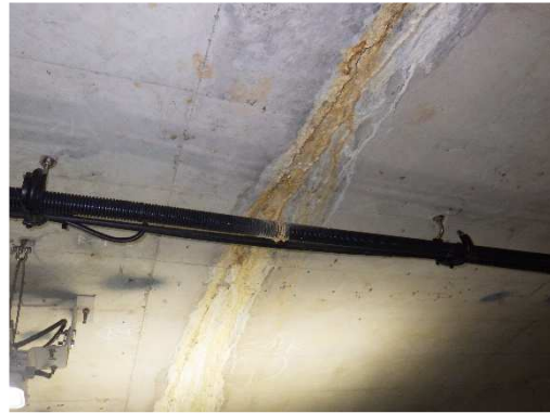
漏水・遊離石灰の析出 (Ⅱ)
