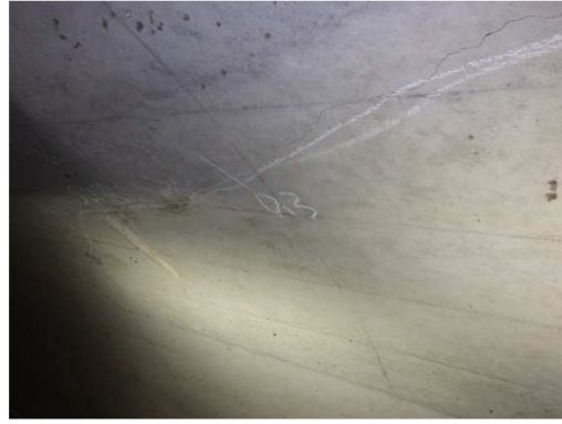
ひび割れ (Ⅱ)
