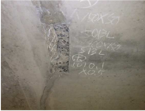
浮き・はく離 (Ⅲ)
