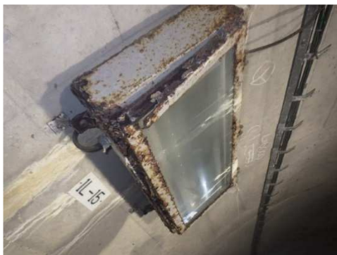
照明器具の劣化・破損（×）
