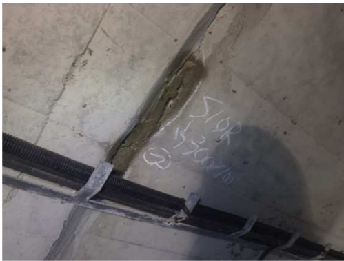
目地に沿った浮き・はく離（Ⅲ）
