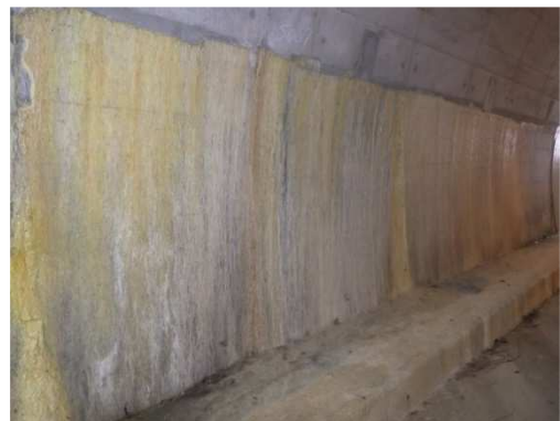
遊離石灰の析出・著しい漏水（Ⅲ）
