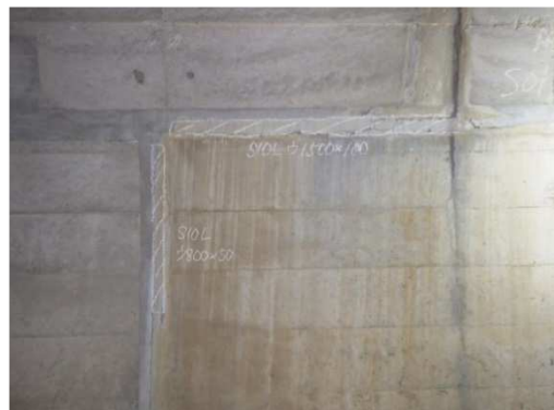
水平・横断目に沿った補修材の 浮き・はく離（Ⅱa）
