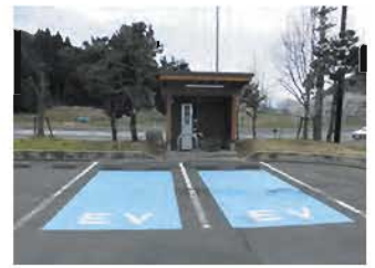
EV車充電ステーション
