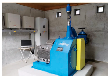
【黒土川発電所】 出力約39.6kWの小規模水力発電所
